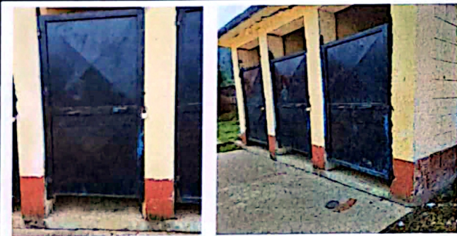
Foto 4: las puertas de los baños estan en malas condiciones y necesita reparación.
