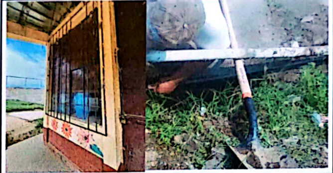
Foto 2: Los balcones de la escuela se necesita cambiarlas. Y tubería principal de agua potable en desperfecto estado.
