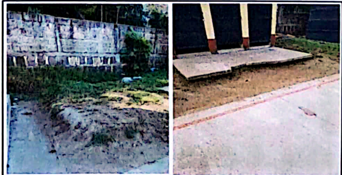
Foto 6: Tambien el pavimento de patio necesita reconstruir.
