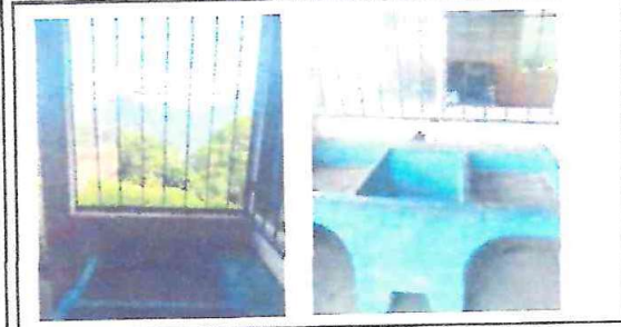
FOTO 3: Ampliación de muros en cocina, debido a que las dimensiones actuales estan reducidas.
