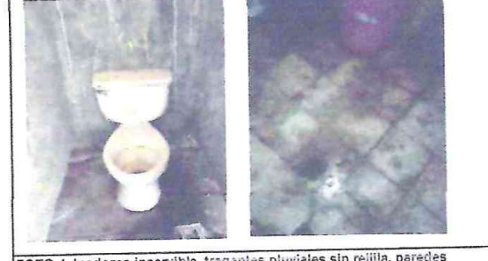
FOTO 4: Inodoros inservible, tragantes pluviales sin rejilla, paredes manchadas y puertas descoloridos.
