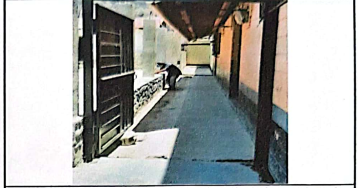
Foto 2: Fundición de losa del corredor y colocación de dos tapaderas de concreto para evitar acumulación de agua
