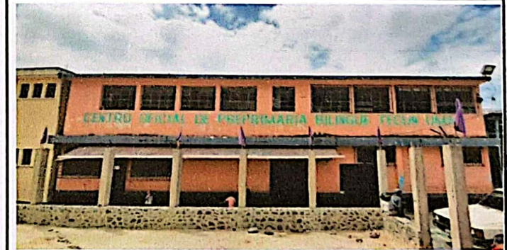
Foto 6: Colocación de techado en Ingreso principal e impermeabilización de losa en terraza para evitar la filtración de agua y humedad
