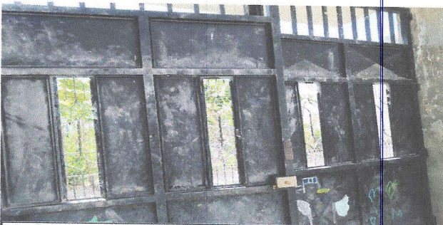
Foto 10: PORTON OXIDADO Y RAYADO
