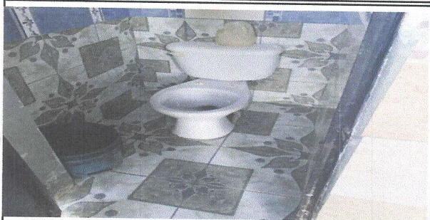
Foto 7: INODORO EN MAL ESTADO Y FALTA DE ACCESORIOS.
