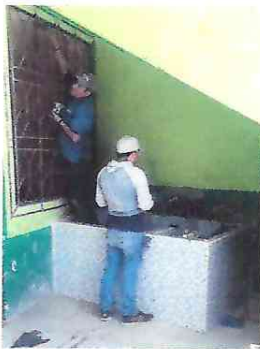
Foto 9: Sustitución de pila en mal estado.
