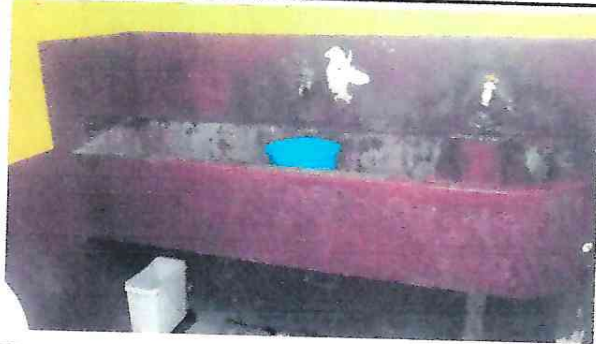
Foto: Lavamanos en mal estado
