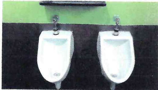
Foto 6: Llave de los mingitorios en mal estado.
