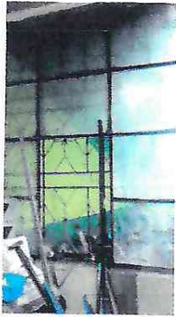
Foto 13: Ventana en mal estado
