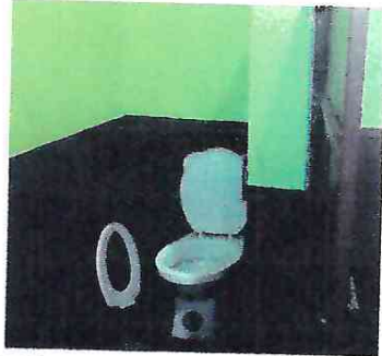
Foto 5: Sanitarios en mal estado.
