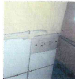
Foto 10: Tomacorriente en mal estado
