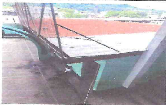
Foto 1. Techo en mal estado
