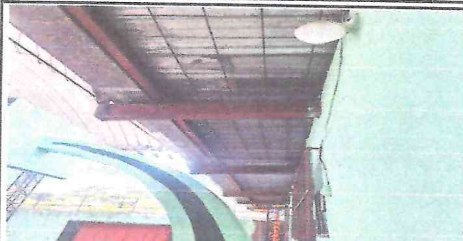
Foto 2: Techo en mal estado
