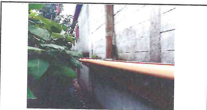
Foto 5: Línea de aguas negras en mal estado
