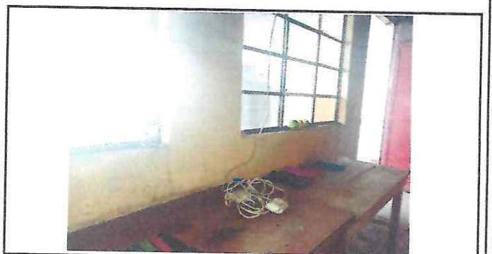
Foto 6: Sistema eléctrico en mal estado
