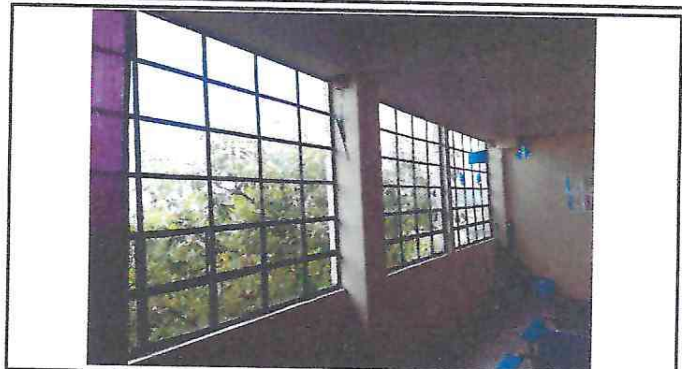
Foto 2: Cortineras de madera en mal estado
