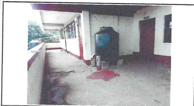
Foto 3: Piso en mal estado en corredor del primer nivel, segundo nivel y dentro de la cocina
