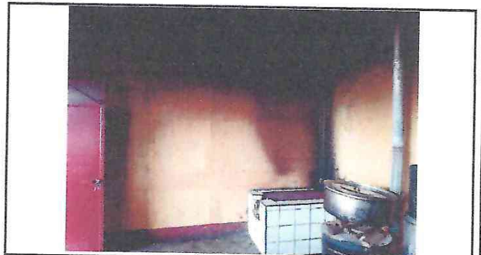
Foto 4: Paredes en mal estado en el interior y exterior de la cocina
