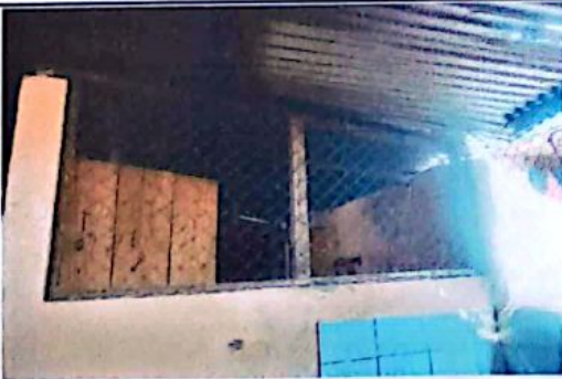
Foto 5: Ventana de cocina marcos de madera apollillados
