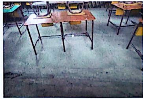
Foto 6: Piso desnivelado, sin poder acomodar las sillas de los niños.
