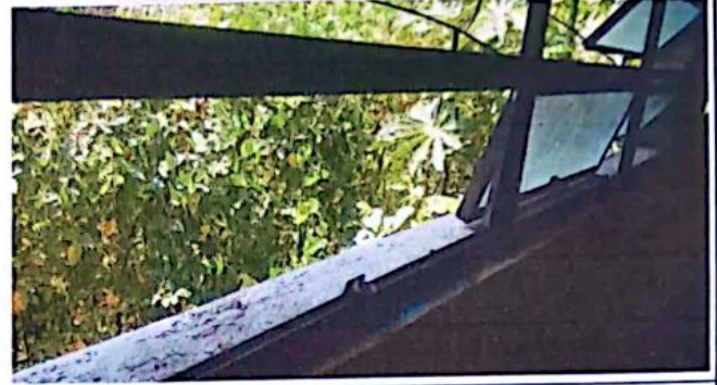
Foto 2: Ventanas con estructuras metalicas oxidadas
