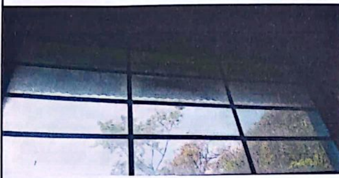
Foto 1: Ventanas selladas sin ningun ingreso de ventilación
