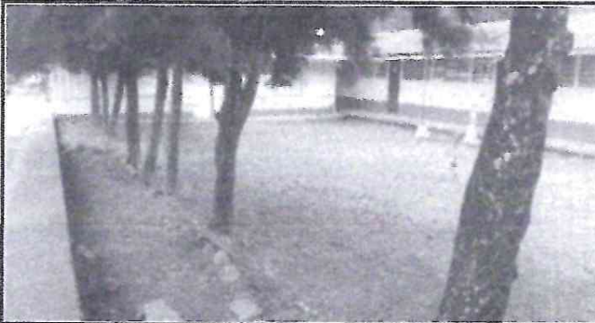
Foto 3: Circulación en mal estado vista desde enfrente de la escuela
