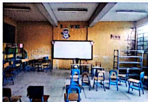
Foto 6: Vista total de pared, con humedad severa
