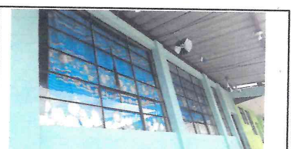
Foto 6: Instalación de balcones en ventanas de aulas por la seguridad de los niños.
