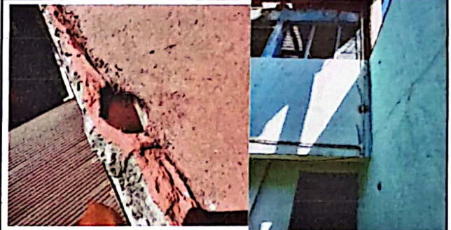
Foto 2: Reparación del canal de conducción de agua pluvial y cambio de sistema de agua
