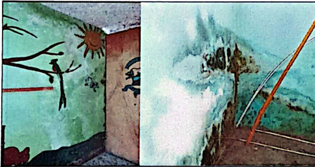
Foto 3: repello y cernido de pared, por filtración de agua.
