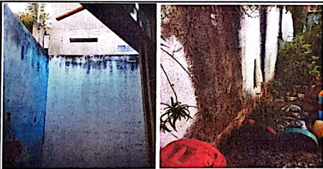
Foto 3: detritado y creación de hongos paredes sucias.
