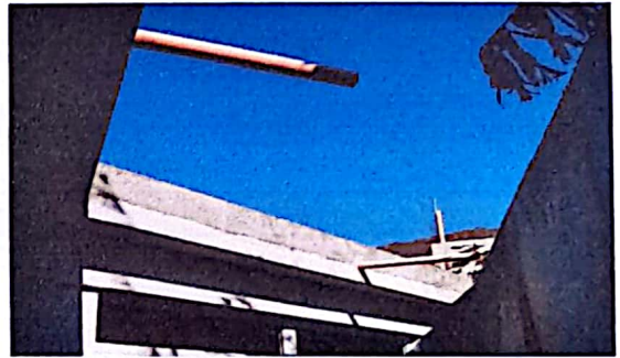
Foto 2: No existe bajada de agua pluviales
