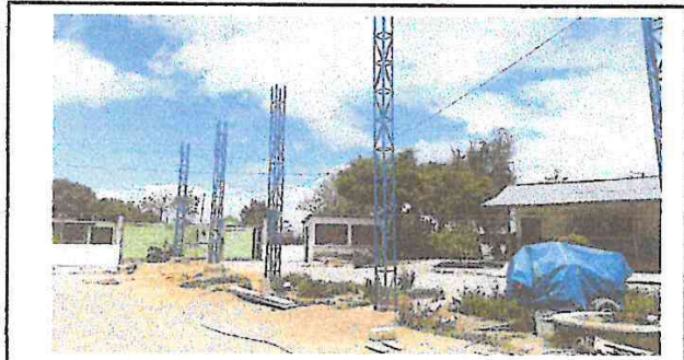
En esta fotografía vemos que se tienen instalados los Joystick que sostendrá la estructura del techado.
