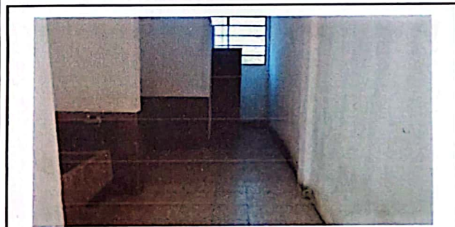
Foto 3: Piso y azulejo incompleto y liso para sanitarios.
