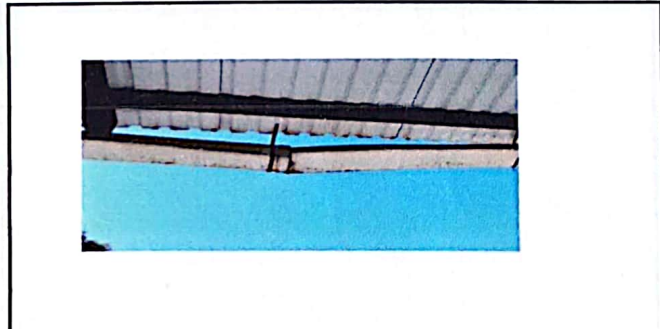
Foto 4: Canales y bajadas de agua pluvial en mal estado
