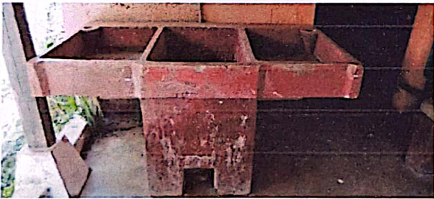
Foto 10: Pila de dos lavaderos de la cocina inservible.
