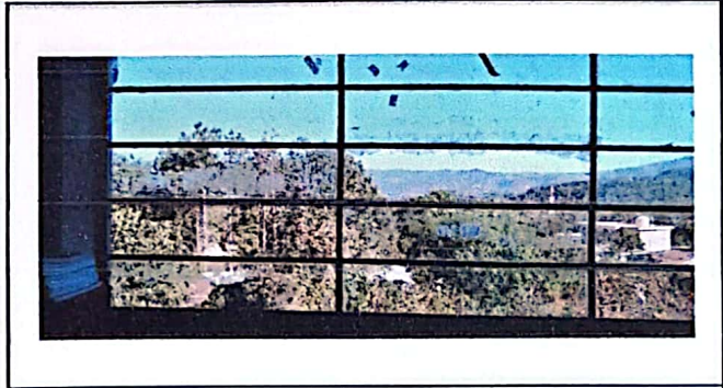
Foto 2: Ventanas con vidrios quebradas.
