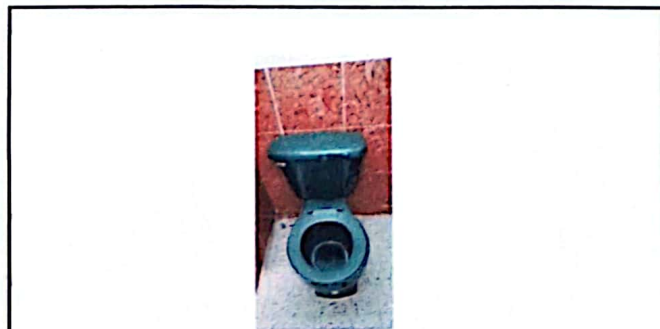
Foto 6: Servicios sanitarios en mal estado.
