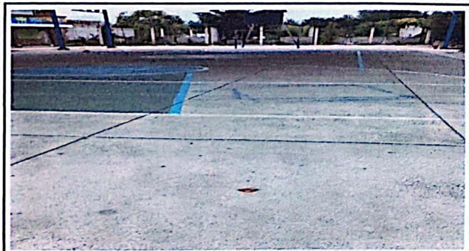
Foto 6: pintura de cancha en mal estado.
