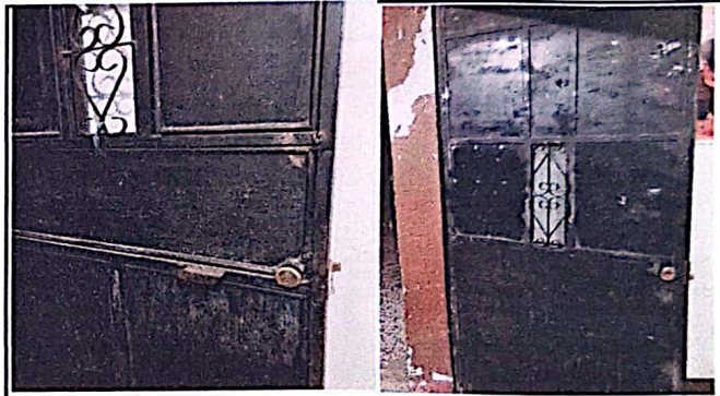
Foto 2: Puertas en mal estado.
