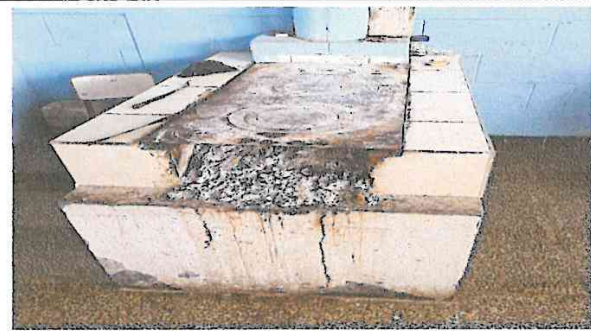
Foto 1: Sustrucción de estufa rural por mal estado.
