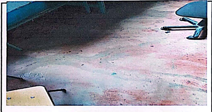
Foto 4: Piso en mal estado
