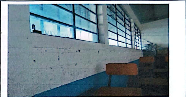
Foto 8: Pared de las aulas en mal estado necesita mantenimiento
