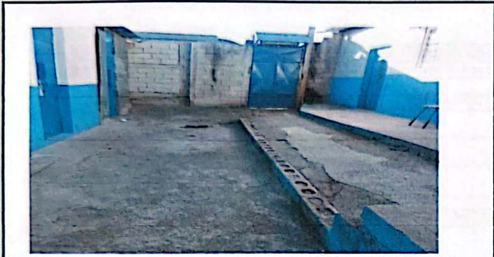
Foto 7: patio en mal estado, necesita reparación
