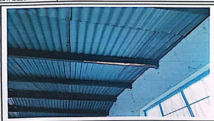
Foto 1: Pareles en mal estado, necesitan ser sustituidos
