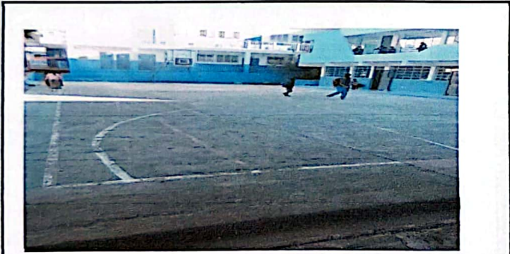
Foto 9: Cancha en mal estado necesita mantenimiento
