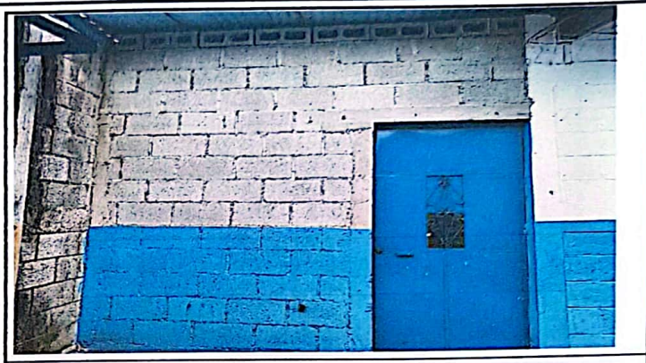
Foto 2: Pared en mal estado, necesita mantenimiento
