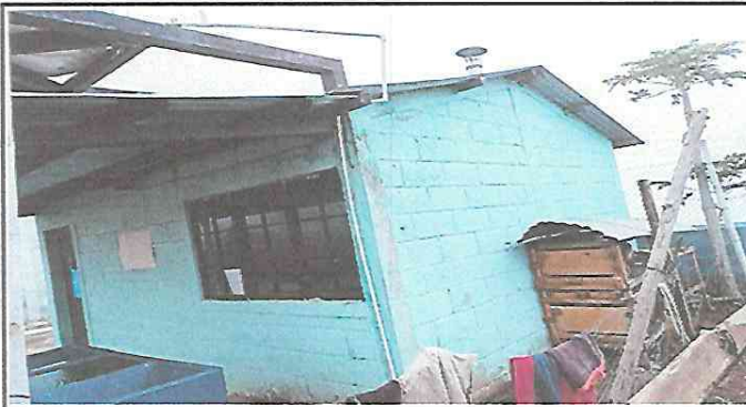
Foto 3: Lavamano en mal estado y hace falta mejoras a la cocina
