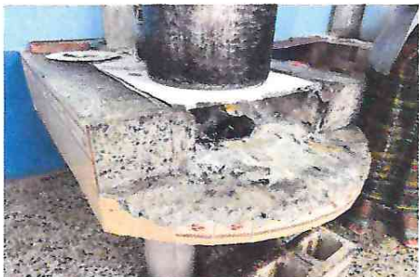
FOTO 1: La cocina se encuentra en mal estado y no cumple con funcionalidad según demanda la necesidad de la escuela.
