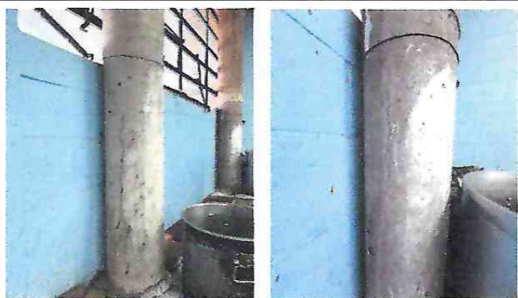
FOTO 3: Con el tiempo y el uso de las chimineas fueron fisurando.
