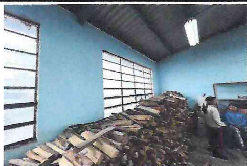
FOTO 5: Espacios restringidos dentro de la cocina y desaprovechamiento de espacios.
