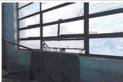
FOTO 4: Las ventanas del aula donde esta ubicado la cocina con vidrio roto y no cumple con ventilación adecuada.
