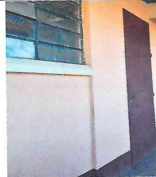
Foto 8: Se necesita cambiar puerta por uno mas grande.
