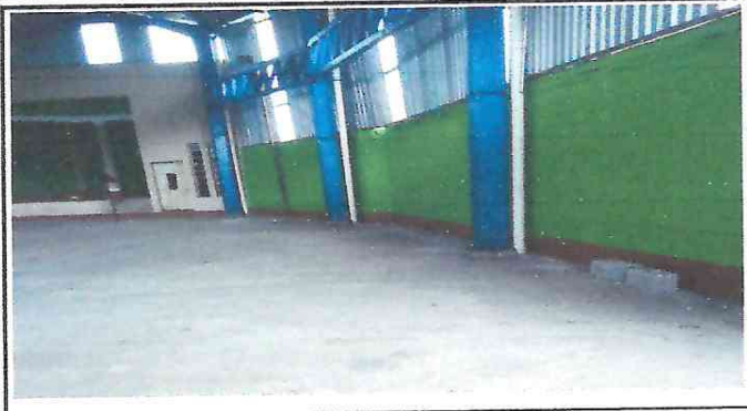
Foto 1: pared en la cancha polideportiva ya pintada
