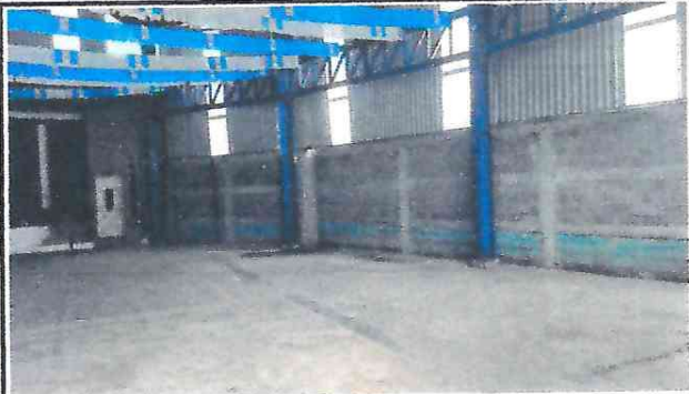
Foto 1: pared en la cancha polideportiva que se va pintar.
