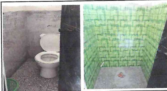
Fotfo 3: Baños en mal estado
