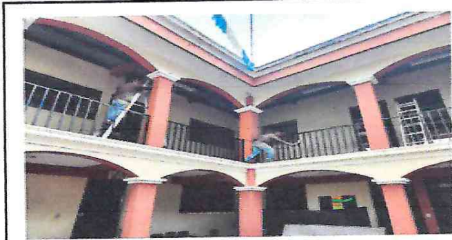
Foto 1 : Deterioro de la pintura de la escuela
