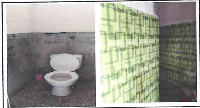
Foto 4: Pared de baño en mal estado.
