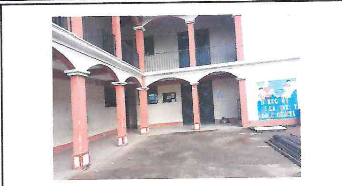
Foto 1 : Deterioro de la pintura de la escuela
