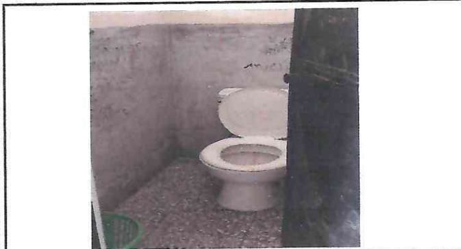
Foto 3: Baños en mal estado
