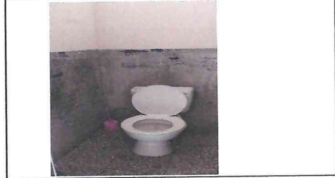
Foto 4: Pared de baño en mal estado.
