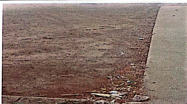
Foto 5: Losa de cemento frente la cocina deteriorada
