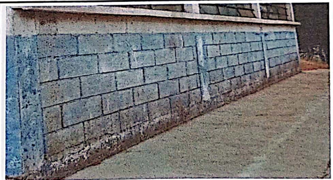
Foto 4: Pintura de las aulas en mal estado
