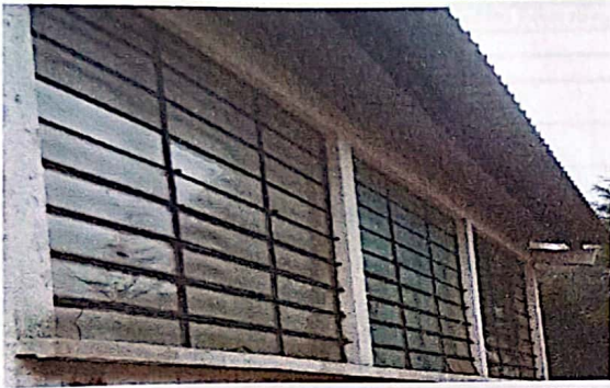
Foto 1: En la parte de atrás de las aulas no hay balcones
