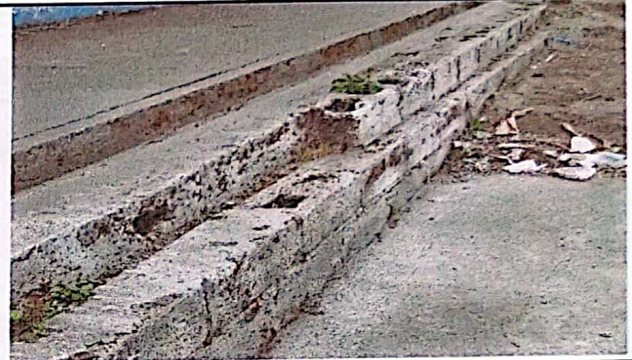
Foto 2: Cuneta a un costado de las aulas en mal estado
