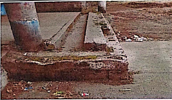
Foto 3: Cuneta frente la cocina en mal estado
