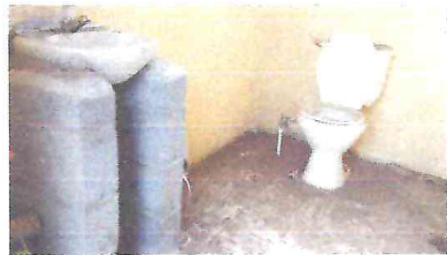
Baños en mal estado
