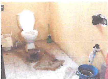
Baños en mal estado
