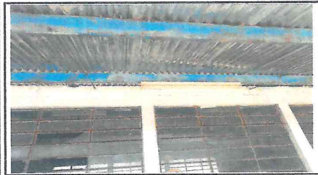
Foto 3: Pintura de Costaneras como estructura de techo en mal estado
