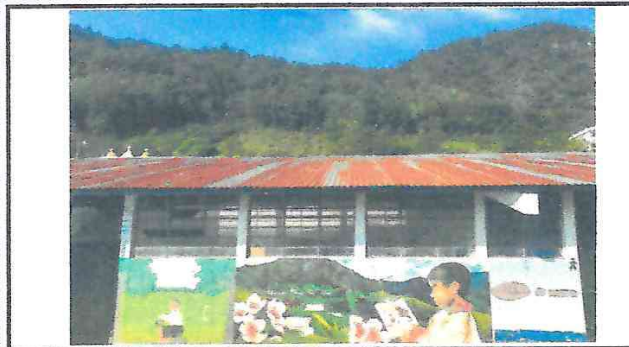
Foto 1: Techo de lámina en mal estado
