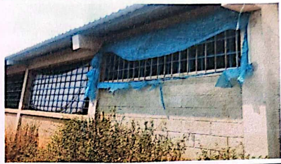
AULAS: sin ventanas
