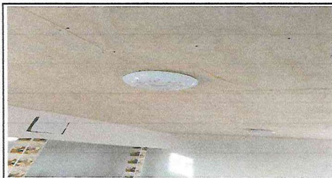
Foto 5 : Techo de la cocina.
