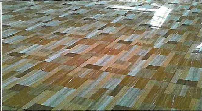
Foto 1: Piso de cocina.
