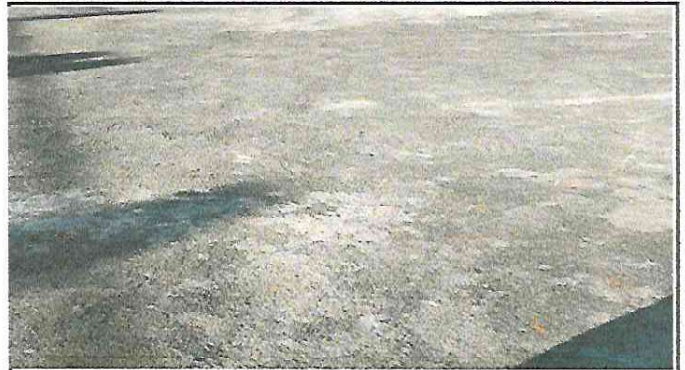
Foto 8 : losa de patio de la escuela .
