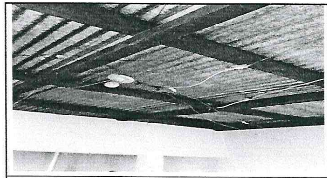
Foto 6 : sistema eléctrico de la cocina, inadecuado
