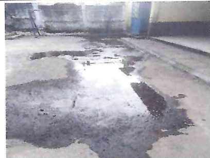
Foto 6: El mismo drenaje cuando colapsa.
