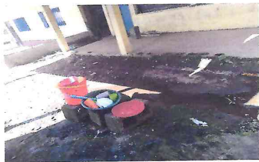
FOTO 5: MURO DEL CORREDOR DE LA COCINA DETERIORADA, NO CUENTAN CON PILA
