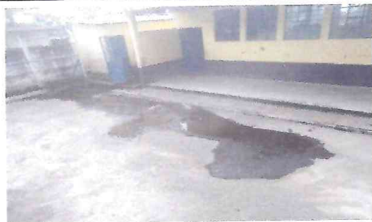
FOTO 3: FOSA SEPTICA EN MAL ESTADO CON FUGA DE AGUAS NEGRAS
