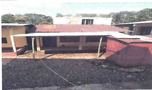
Foto 5: Láminas deterioradas de la cocina.
