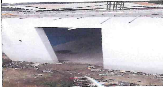
Foto 1: Falta puerta y pintura
