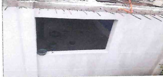
Foto 2: Falta Ventana y pintura
