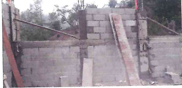
Foto 2: Falta techo de la cocina
