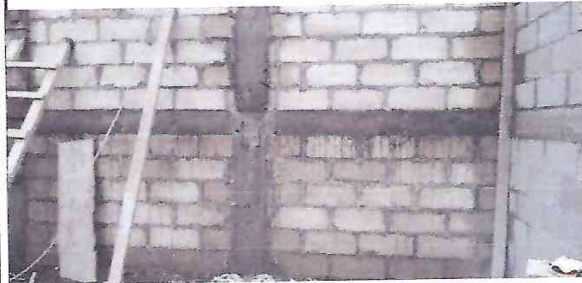
Foto 1: Falta techo de la cocina
