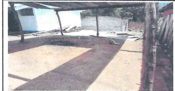
Foto 3. Plancha de concreto de patio. Area de juego para alumnado.
