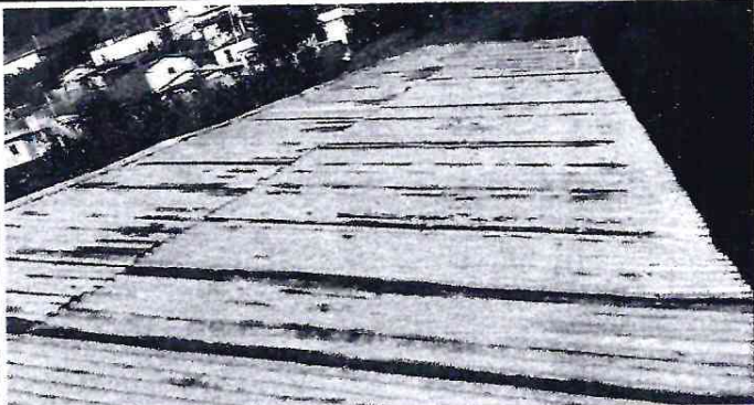
techado en mal estado
