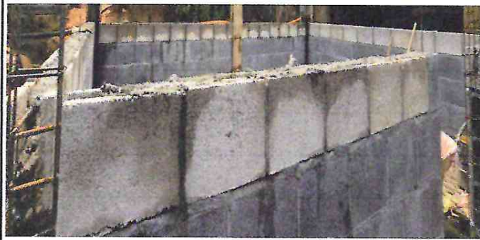
obra no culminado, falta puerta y ventna
