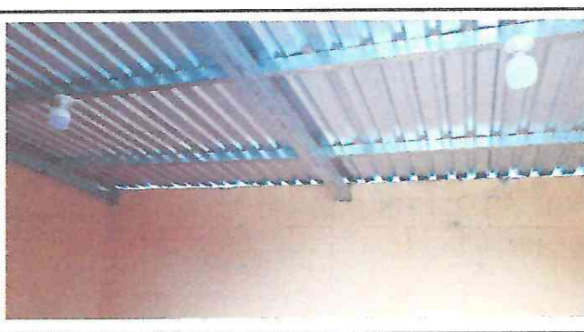
Foto 4: Techado y sistema electrico de cocina
