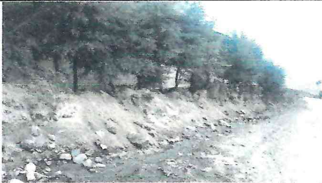
Deslizamiento de tierra
