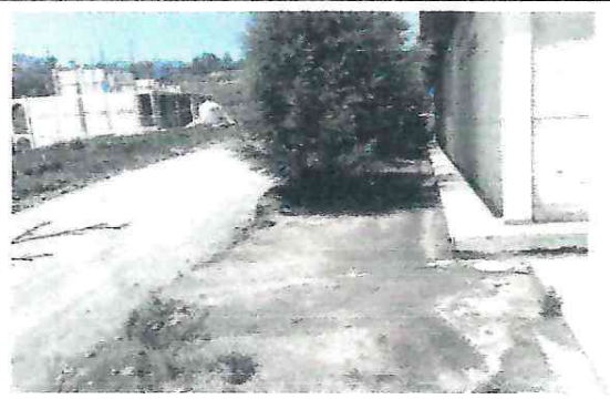
Deslizamiento de tierra
