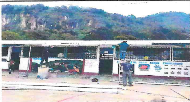
Foto 3: Sustitución y colocación de canales de bajada de agua pluvial en frente de la escuela
