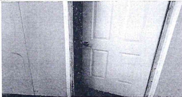
Foto 1: La chapa de la puerta de la cocina del lado norte ya no funciona
