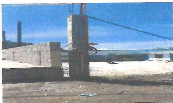
Foto 3: Columna nueva de la distribución de la red eléctrica.
