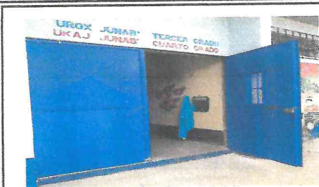
Foto 1: Puertas instaladas adecuadamente
