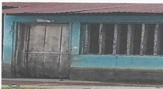
Foto 3: Sustrucción de puerta de aula.
