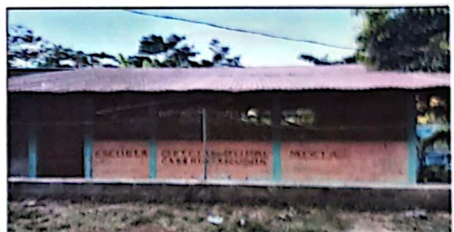
Foto 4: Primer módulo, se necesita 3 balcones y reparación de vidrios.
