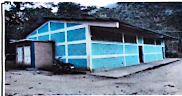
Foto 3: Este es el segundo módulo de la Escuela de Xecuchin, se necesita 4 balcones en la parte frontal.
