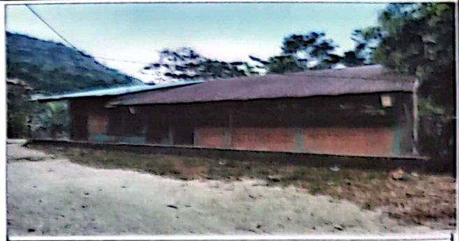
Foto 2: Este edificio corresponde al primer módulo de la Escuela de Xecuchin, necesita cambio de láminas y pintura.
