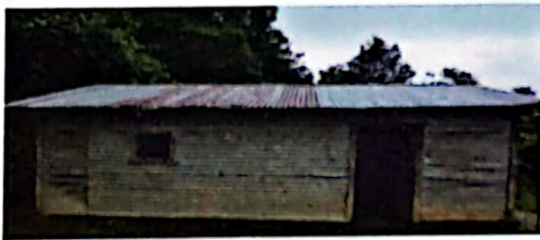
El techo del establecimiento esta muy deteriorado urge el cambio de techo.
