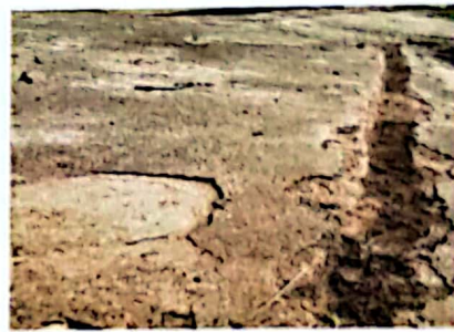
El centro educativo necesita cuando de piso porque actualmente el piso esta en malas condiciones.
