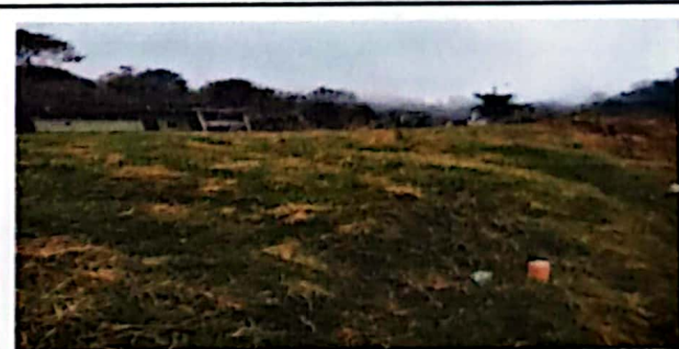
Foto 6: Aquí pensamos invertir la mayor parte del dinero para evitar que poco a poco se esté yendo la tierra y evitar que poco a poco se agrande el barranco.
