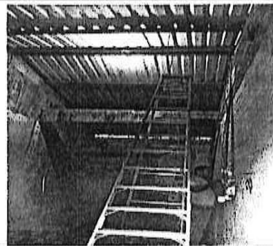
FOTO DONDE SE EMPEZO LA NUEVA INSTALACION DE LA LUZ DE LA ESCUELA, POR EL ELECTRICISTA
