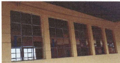
Foto 8: Vidrios de ventanas requieren colocación.
