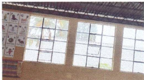
Foto 7: Vidrios de ventanas requieren colocación.
