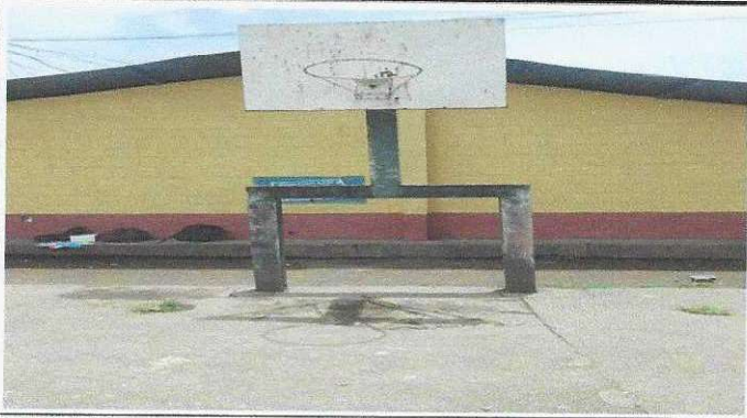
Foto 1. losa de patio en mal estado.
