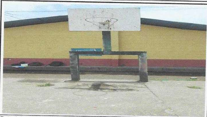
Foto 1. losa de patio en mal estado.
